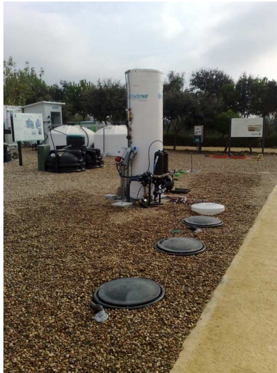
Figura 1.- Vista del sistema SBS® instalado en el Centro de I+D+i de CENTA
